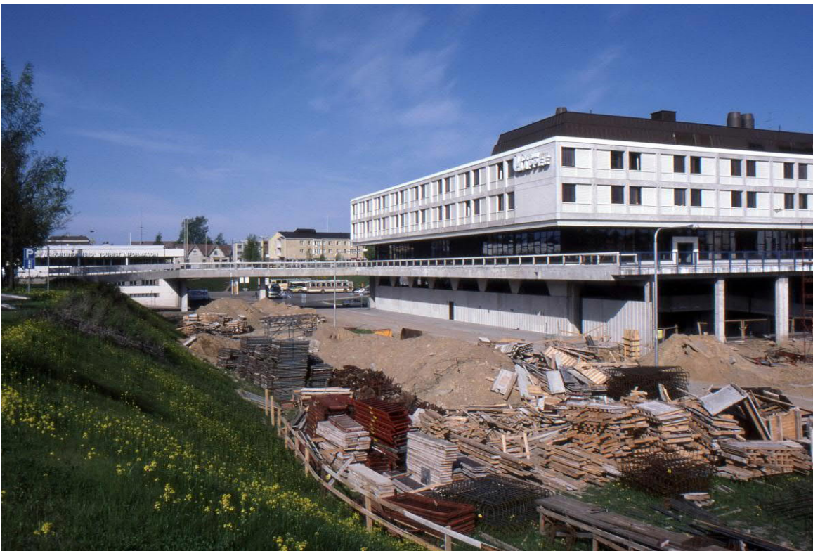
Kuva 39. Hotelli Lappeen viereen ryhdyttiin rakentamaan kauppakeskus Iso-Kristiinaa 1980-luvulla. Kuva kauppakeskuksen rakentamisen alkua ajoilta. Vasemmassa reunassa näkyy vanha, purettu linja-autoasema, jonka paikalla on nykyisin kauppakeskus Galleria. Hotelli Lappee kuvan oikeassa reunassa. Kuva on otettu nykyisen Lappeenkadun kohdalta länteen. (Lappeenrannan museot / Finna/ Kenzi Rinno 1986-1989)
